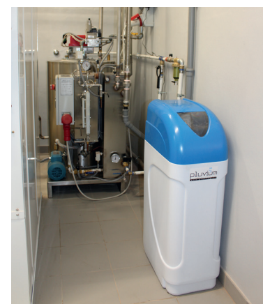
La caldaia a vapore per le due asciugatrici
